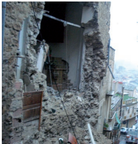
Chiesa Itria - Lo squarcio provocato dal crollo del muro perimetrale
