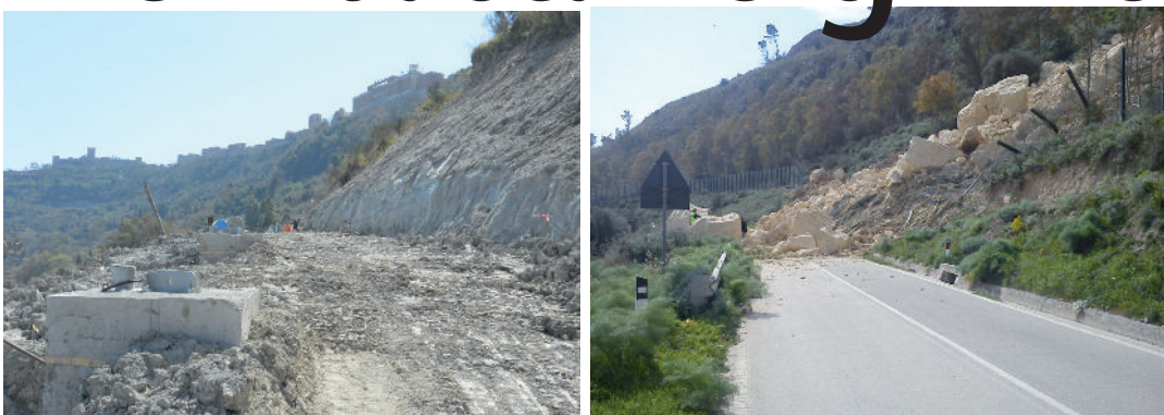
I lavori a monte che hanno interessato la strada per Villarosa. A destra la frana sulla Ss290 Villapriolo-Calascibetta
