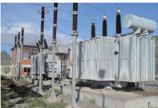
In alto i due trasformatori danneggiati. A destra la delegazione che ha effettuato il sopralluogo
