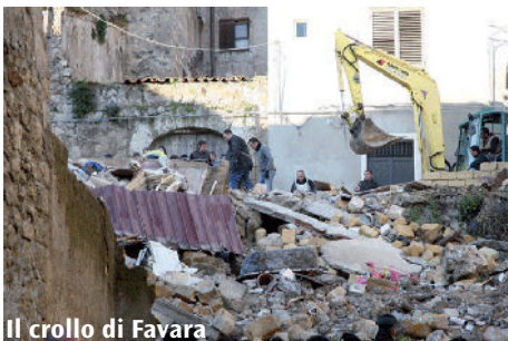
Il crollo di Favara
