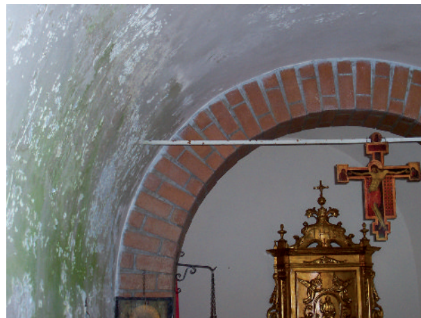
La cappella del SS. Sacramento con le tracce evidenti delle infiltrazioni di acqua piovana
