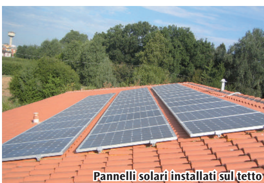
Pannelli solari installati sul tetto
